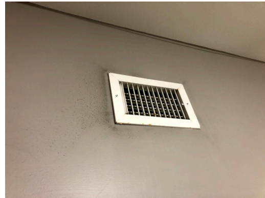
14. Dormatory - HVAC Louver
