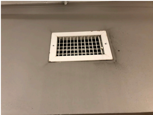
15. Dormatory - HVAC Louver
